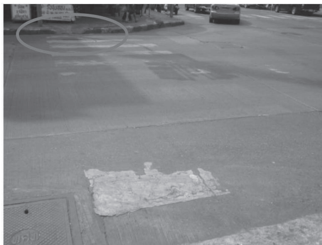
รูปที่ P7b - 2 การติดตั้งลาดทางบริเวณทางเท้าที่ไม่ได้มาตรฐาน
